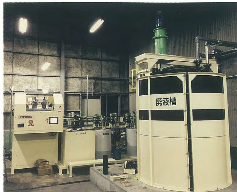
排水処理設備
